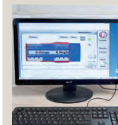
PC de maintenance à distance
